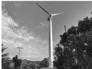
KWT300 設置事例 (フィリピン ロンブロン島)
